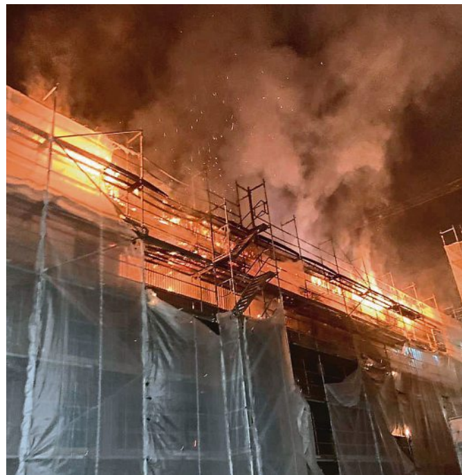
Den Großbrand auf der Baustelle „Großer Berg“ bekämpften 180 Feuerwehrleute.
