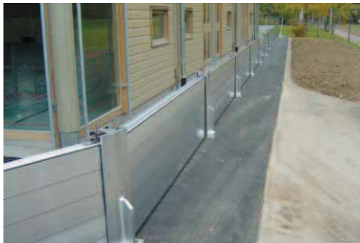
Umlaufender Hochwasserschutz mit teilmobilen Schutzelementen
