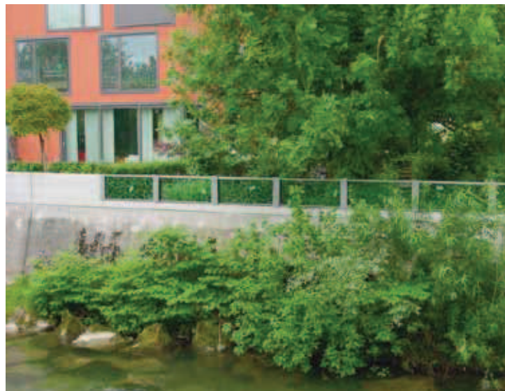
Hochwasserschutzwand mit Sicherheitsglas
